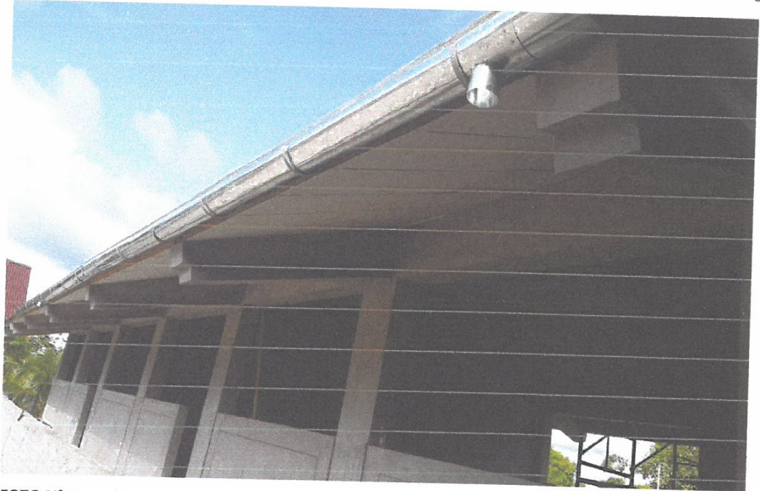
FOTO N° 15. Módulo 3, la vista da cuenta de lo trabajos de instalado de canaletas para el sistema de evacuación de aguas pluviales
