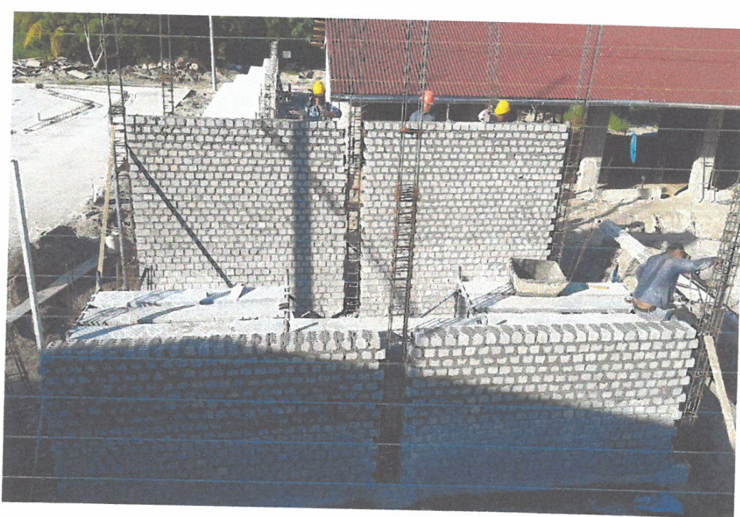
FOTO N° 14.- Asentado de muro de ladrillos en aparejo de cabeza; la vista precisa el desarrollo de los trabajos que viene desplegándose en uno de los módulos de SS.HH.
