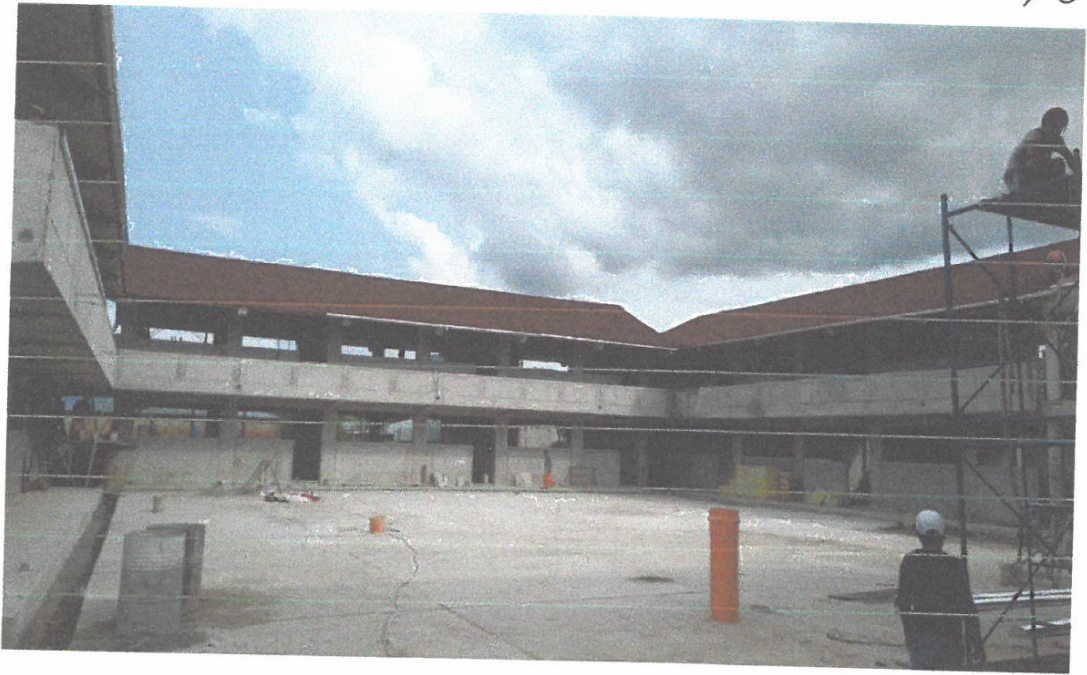
FOTO N° 01. Vista elocuente de los trabajos de acabados que viene recibiendo cada uno de Los módulos de la Institución Educativa Balsapuerto
